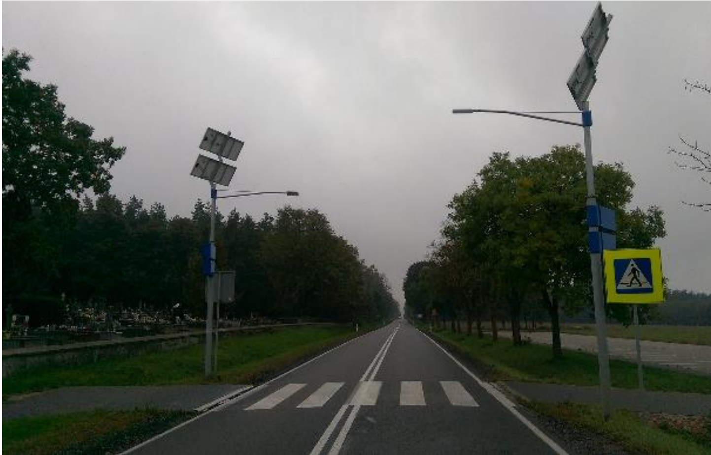
Rys.1. Przejście dla pieszych z systemem oświetleniowym zasilanym panelami PV z akumulatorami (Zdjęcie własne).
